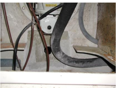
Hul i motorrum
